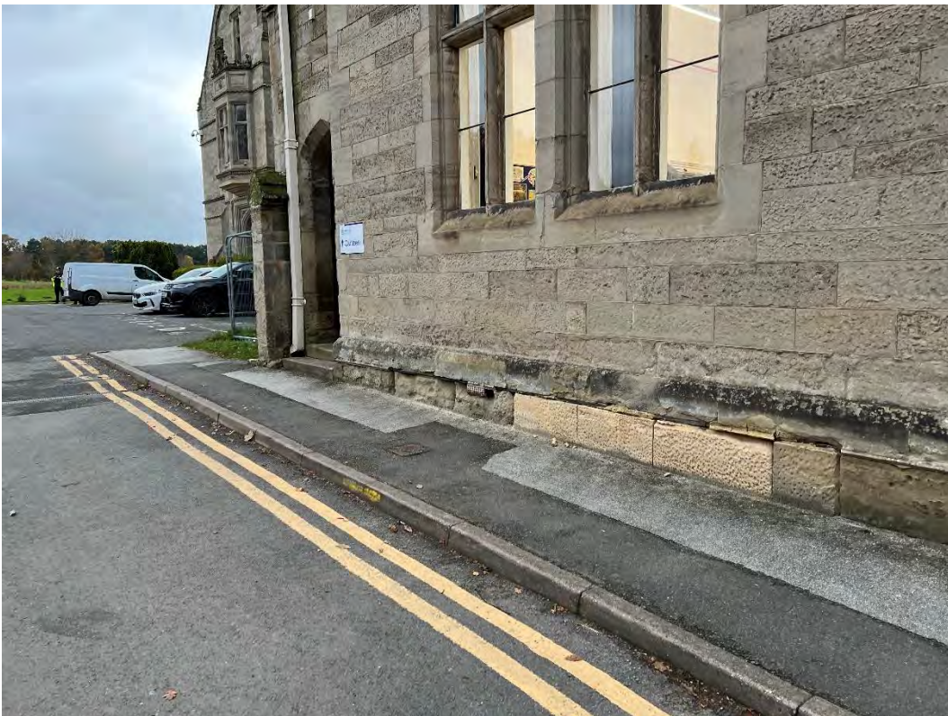
1032) Heavily eroded stones
